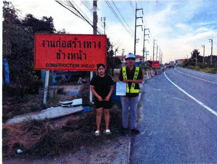
รูปที่ ๑ ถนนของโครงการ กม.ที่ ๘+๓๐๐ ด้านขวาทาง
